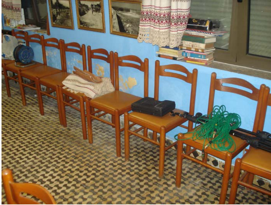
Φώτο 3: Εμφάνιση υγρασίας στο εσωτερικό του κτιρίου
